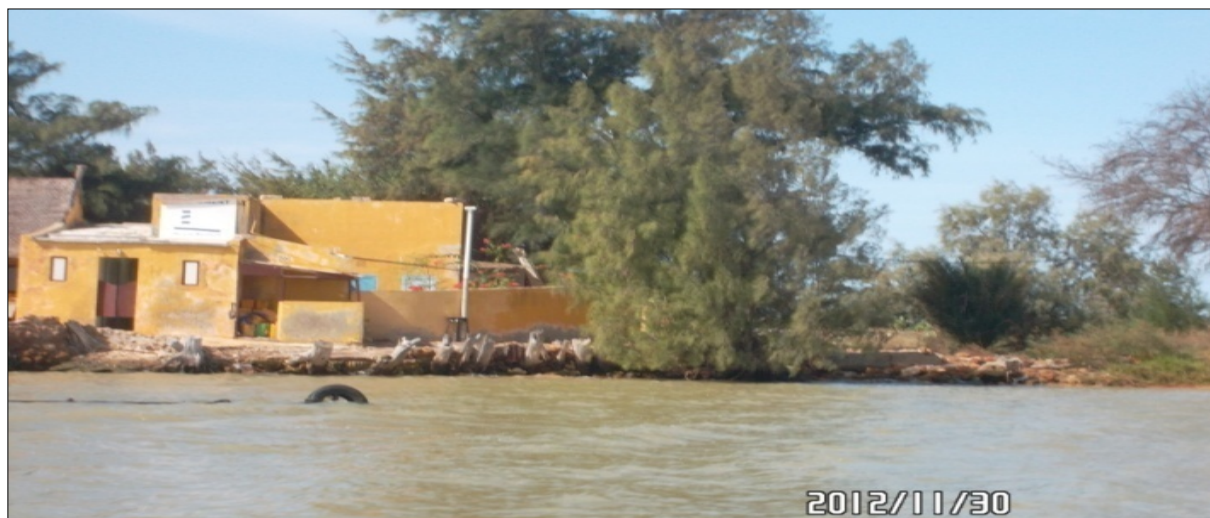
Figure 17 : Campement de la POSTE sur la Langue de Barbarie complètement détruit.
