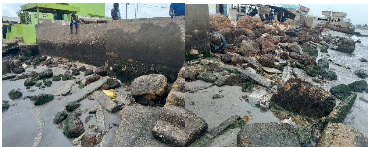
Figure 19 : Station d'essence endommagé par l'érosion côtière à Joal.
