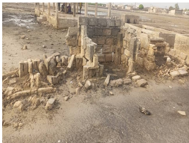
Figure 20 : Site de transformation de Djirnda détruit
