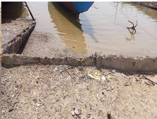
Figure 21 : Digue de protection de Félire détruit par l'érosion
